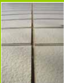
劣化でコーキングがやせ細っている
