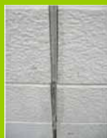
外壁断面からの剥離
