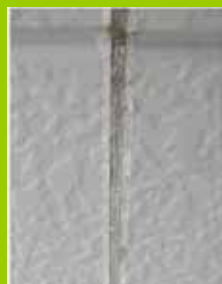
劣化でひび割れている
